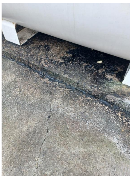
Nærfoto af oliespild, der er fundet under tanken.
