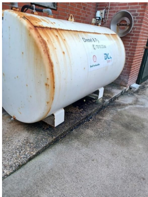
Dieseltank placeret udenfor.
