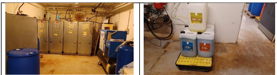
Olietanke samt opbevaring af vaskemidler i kælder.
