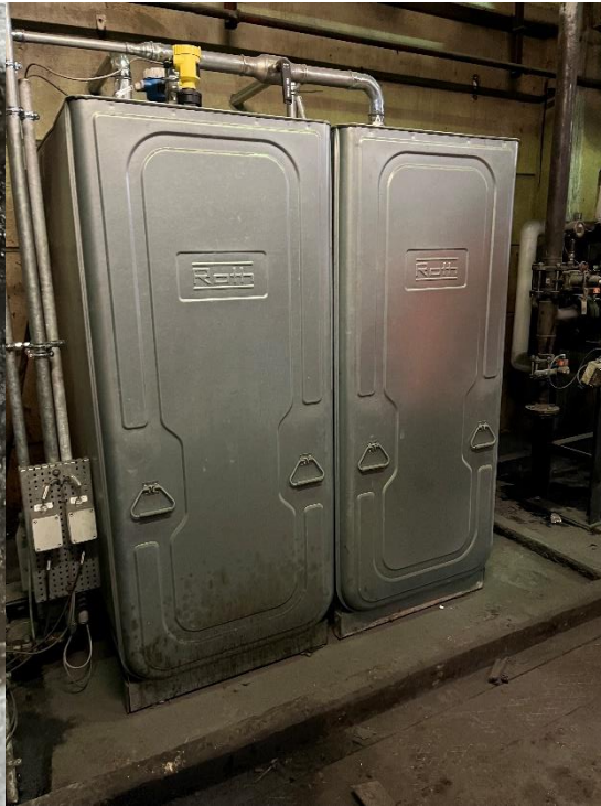
Indendørs tanke til spildolie med utilstrækkelig opkant og direkte afløb til brøndsysteem
