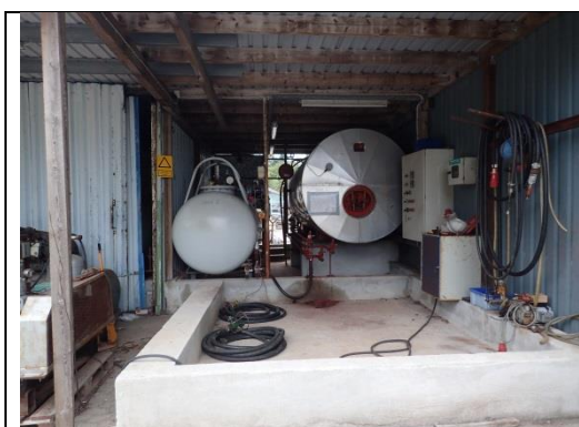
Billede nr. 1: Ammoniak anlæg (2016)
