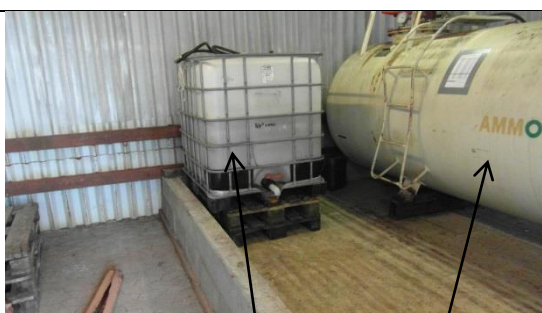
Billede nr. 2: Oplagsplads til tank med ren ammoniak og palletank med ammoniakvand (2016)
