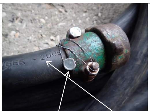
Billede nr. 9: "Ammoniakslangen" er produceret i 2009 og sidst tæthedsprøvet i 2016. (2016)
