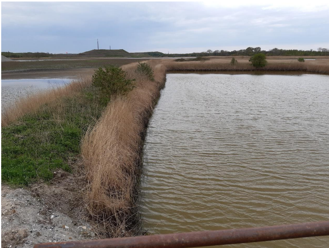
Foto 20: Udsyn fra overløbsbygværk i retning mod syd. Forrest ses sedimentationsbassin, bagerst ses det sydlige deponeringsområde.
