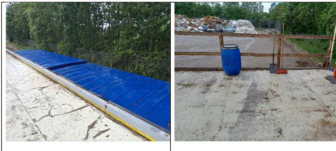
Figur 10. Omlasteanlæg til madaffald (rampen, containere, belægningen).
