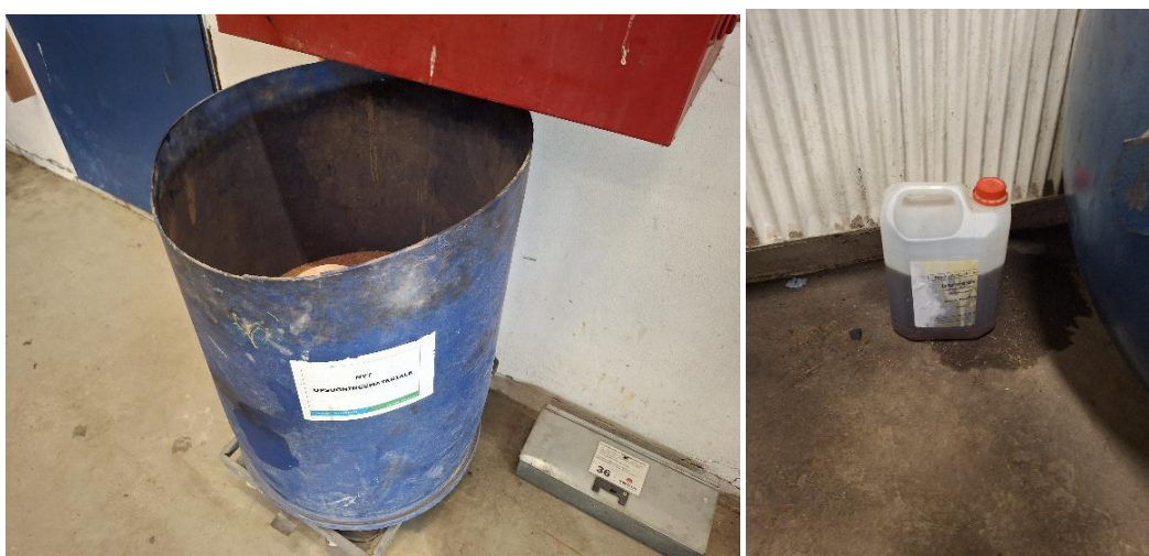
Figur 13. Opsugningsmateriale, ikke oprenset oliespild til belægningen.
