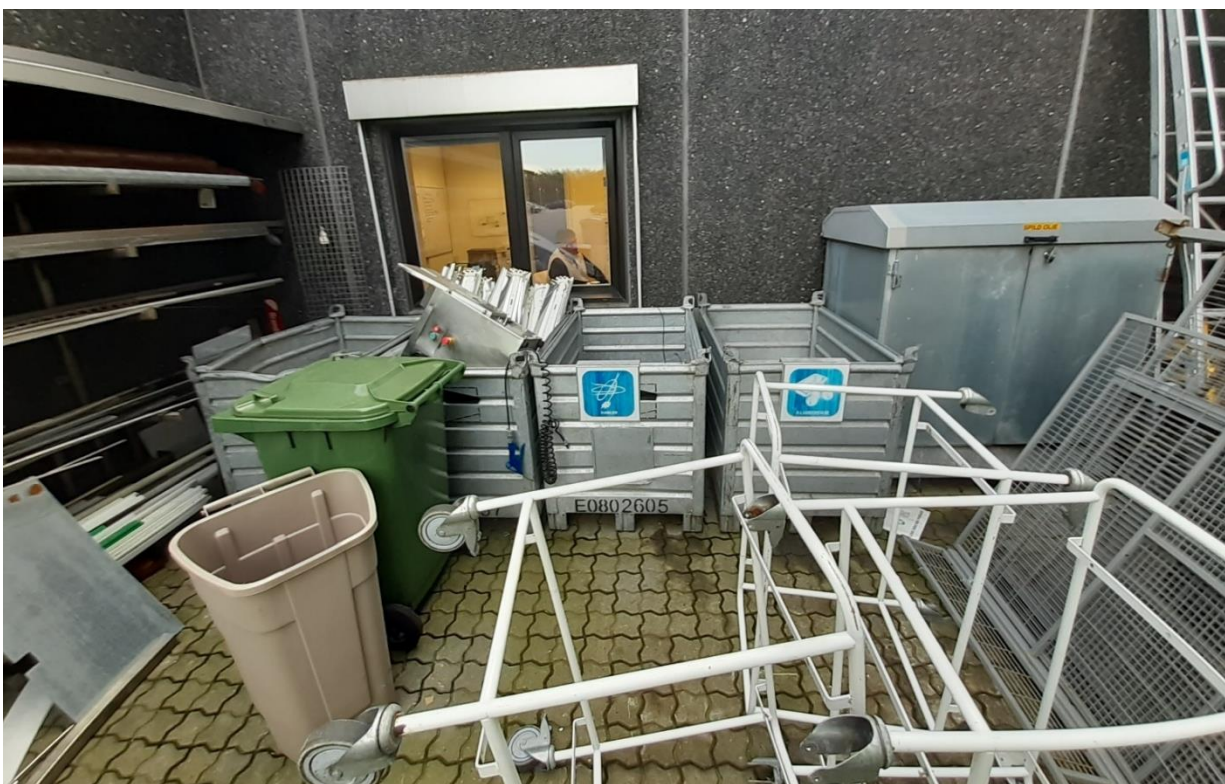
Opbevaring af farligt affald udenfor i den aflåste men ikke overdækkede affaldsgård
