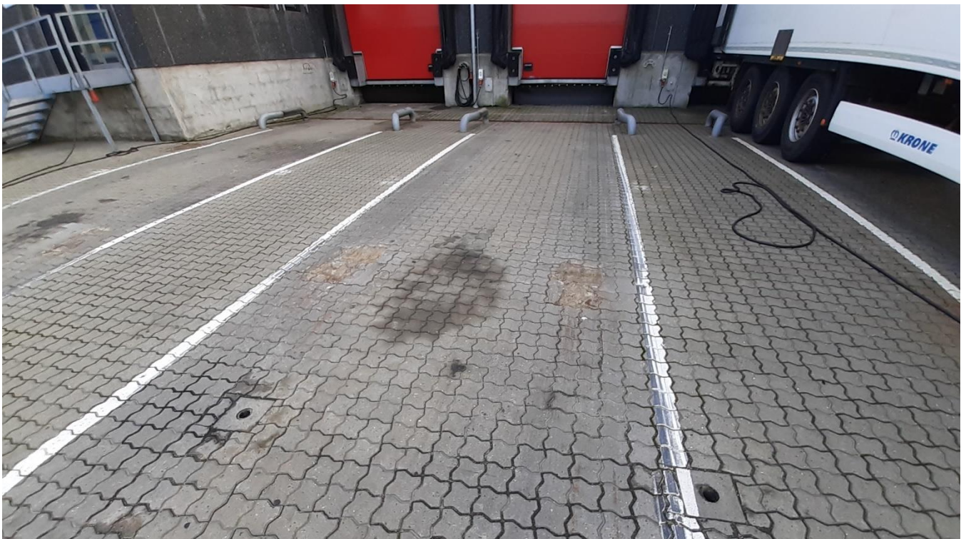
Udendørs er der flere steder sf-sten der er i stykker eller mangler, hvilket er i strid med godkendelsens vilkår
