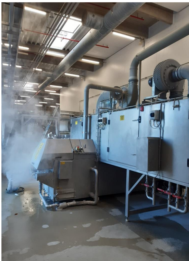
Kassevaskanlægget hvor en stor del af processpildevandet stammer fra
