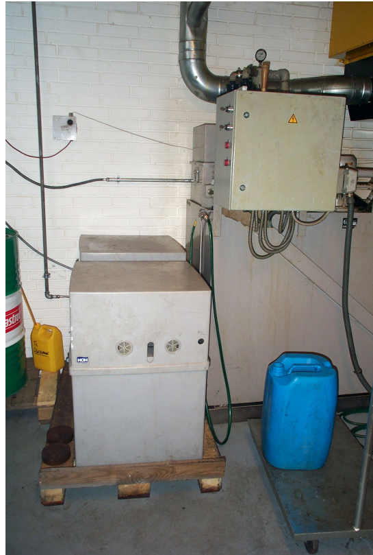
Foto: Omvendt osmose anlæg til blødgøring af vand til køle/smøremidler, bygn. 16 A.
