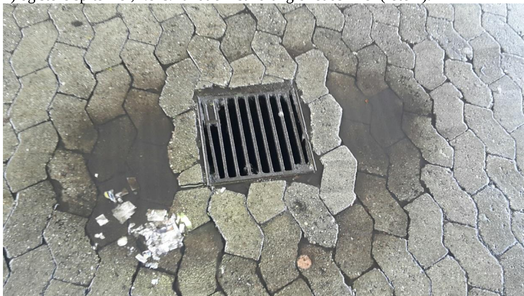
Foto 1: Lunker ved kloakrist på salgsplads.
