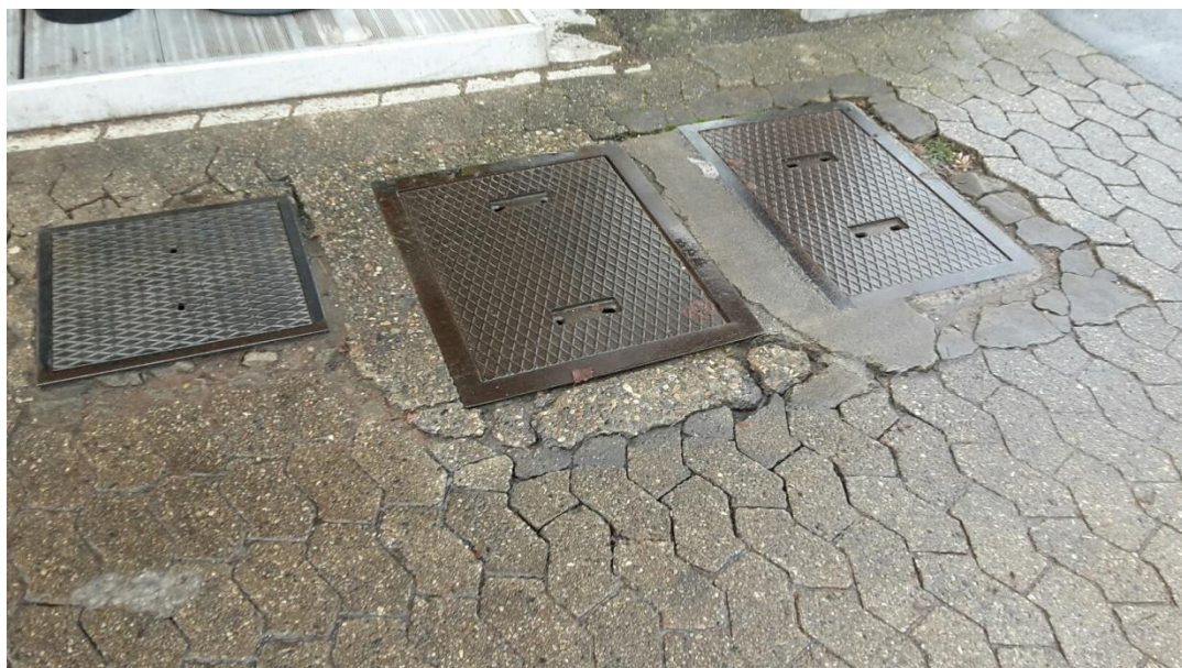
Foto 2: Store sprækker rundt om sandfang/olieudskiller på salgsplads.
