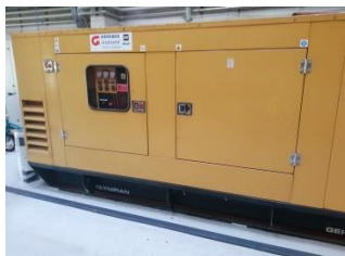
Billede nr. 1. Nødgenerator.
