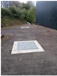
Billede nr. 12 Påfyldningsplads- Nedgravet Fyringsolietank.
