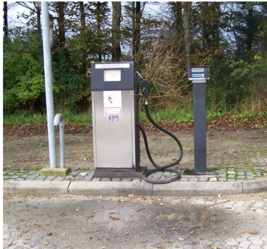
Diesololiestander, der forsynes med dieselolie fra 10.000 liter nedgravet tank
