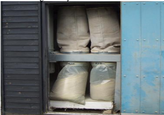
Posefiltre for træstøv fra tømrerværksted
