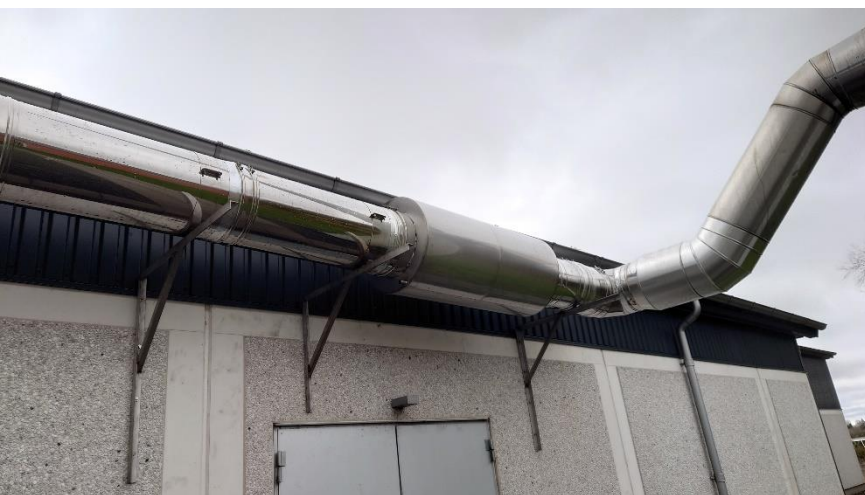
Rørlyddæmper opsat i forbindelse med afkastet fra halmfyret.
