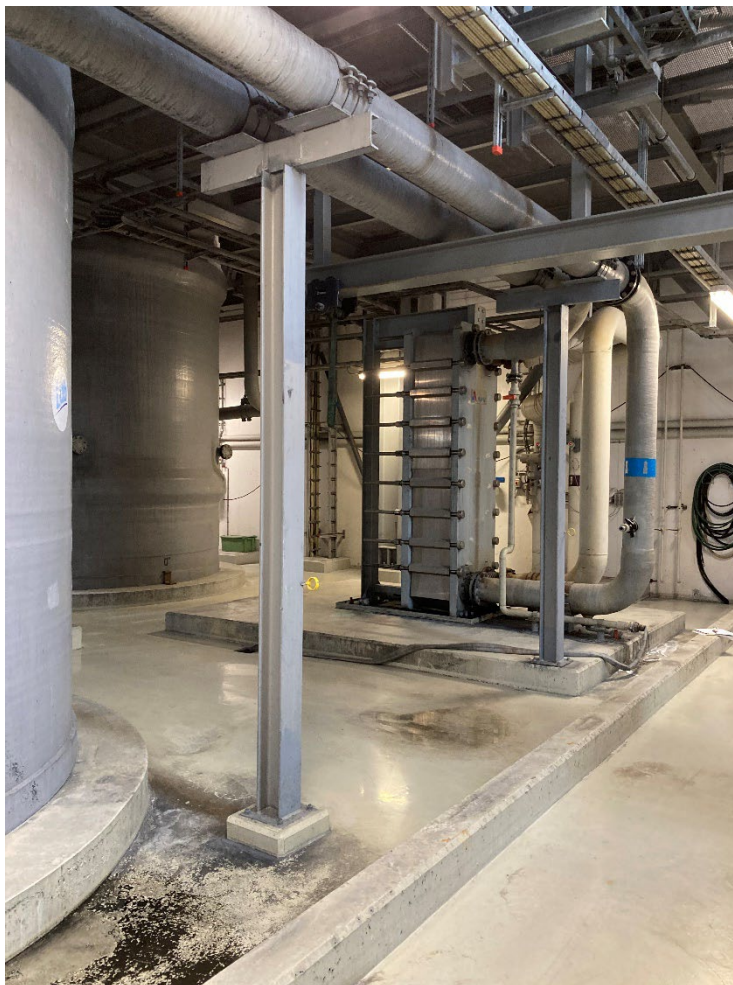
Figur 2: Eksisterende pladevarmeveksler til ovn 4 (enheden placeret midt for og bagerst i foto). Den eksisterende pladevarmeveksler opgraderes til en større i forbindelse med dette projekt. Der etableres desuden en ny pladevarmeveksler på det uudnyttede areal foran den eksisterende pladevarmeveksler, som kobles til den nye varmepumpe.
