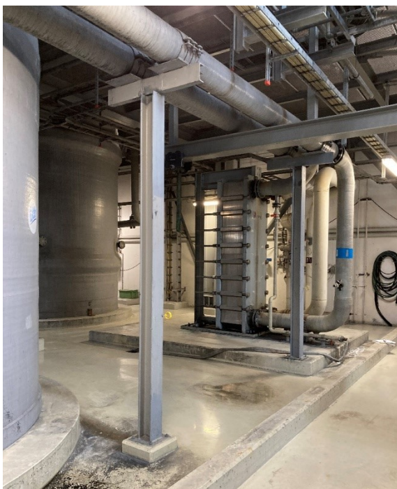
Figur 2: Eksisterende pladevarmeveksler til ovn 4 (enheden placeret midt for og bagerst i foto). Den eksisterende pladevarmeveksler opgraderes til en større i forbindelse med dette projekt. Der etableres desuden en ny pladevarmeveksler på det uudnyttede areal foran den eksisterende pladevarmeveksler, som kobles til den nye varmepumpe.
