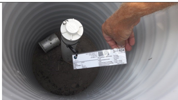
M3 – inden i beskyttelsesbrønden og med vandtæt lukning samt lås
