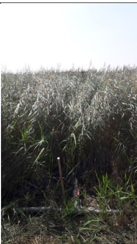
En af de 2 recirkuleringsledninger med første forstøver blandt tagrørene højt i den nordøstlige del af enhed A.
