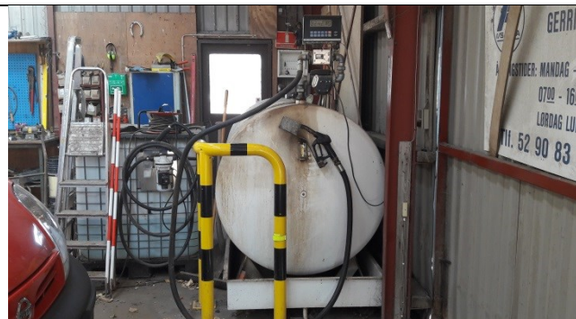
Olietank med spildbakke i garagen.
