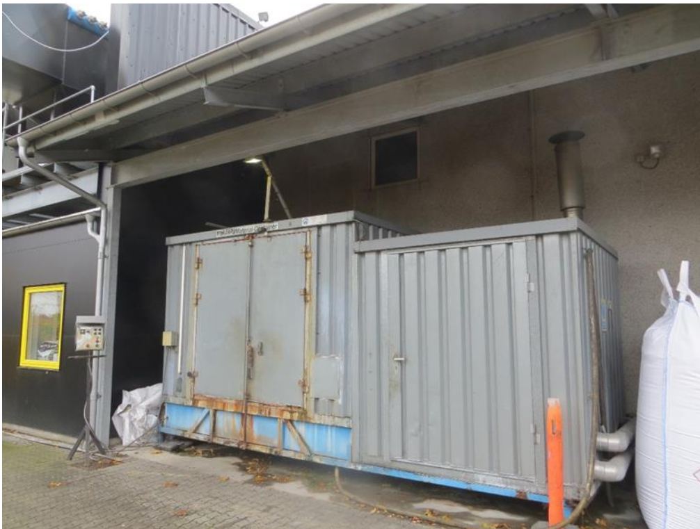
Vaskemaskinen til tomme emballager bruges daglig. Vaskevandet tilføres slaggebadet. Aktiviteten og beskrivelse af driften skal med i den miljøtekniske beskrivelse. Bemærk BAT-konklusioner for vask af beholdere med klinisk risikoaffald.
