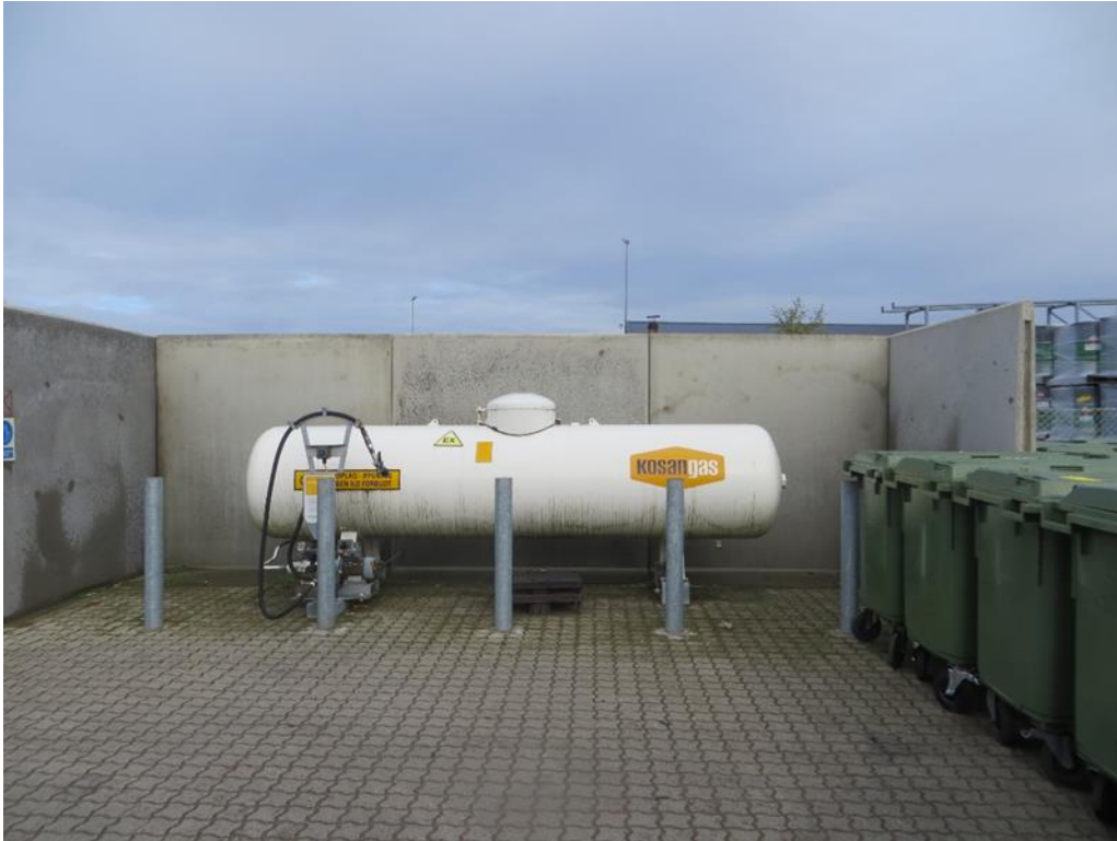
Flaskegas tank opstillet på lageret for tom emballage med brandvæg mod affaldslage. Gassen bruges til trucks. Tanken skal med i miljøteknisk beskrivelse
