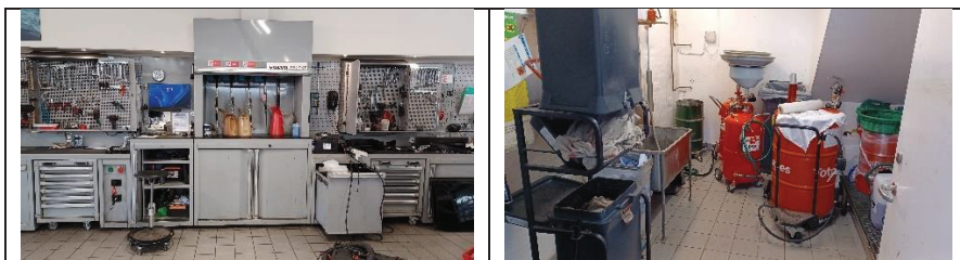
Olieforsyning fra kælder samt olieopsamling
