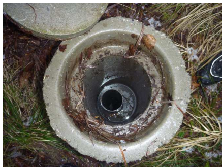
Fig. 3 Der var ikke prop og lås på forerør i boring B2
