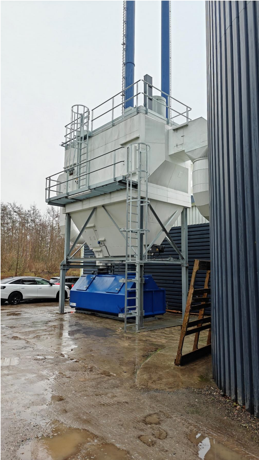
Det nye elektrofilter til rensning fra den store kedel.
