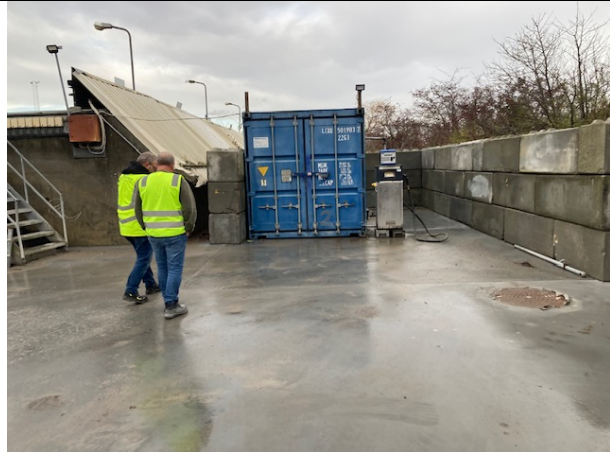
Foto 9 Tankplads med skibscontainer med olietank inden i.
