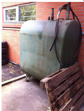
Tank til spildolie
