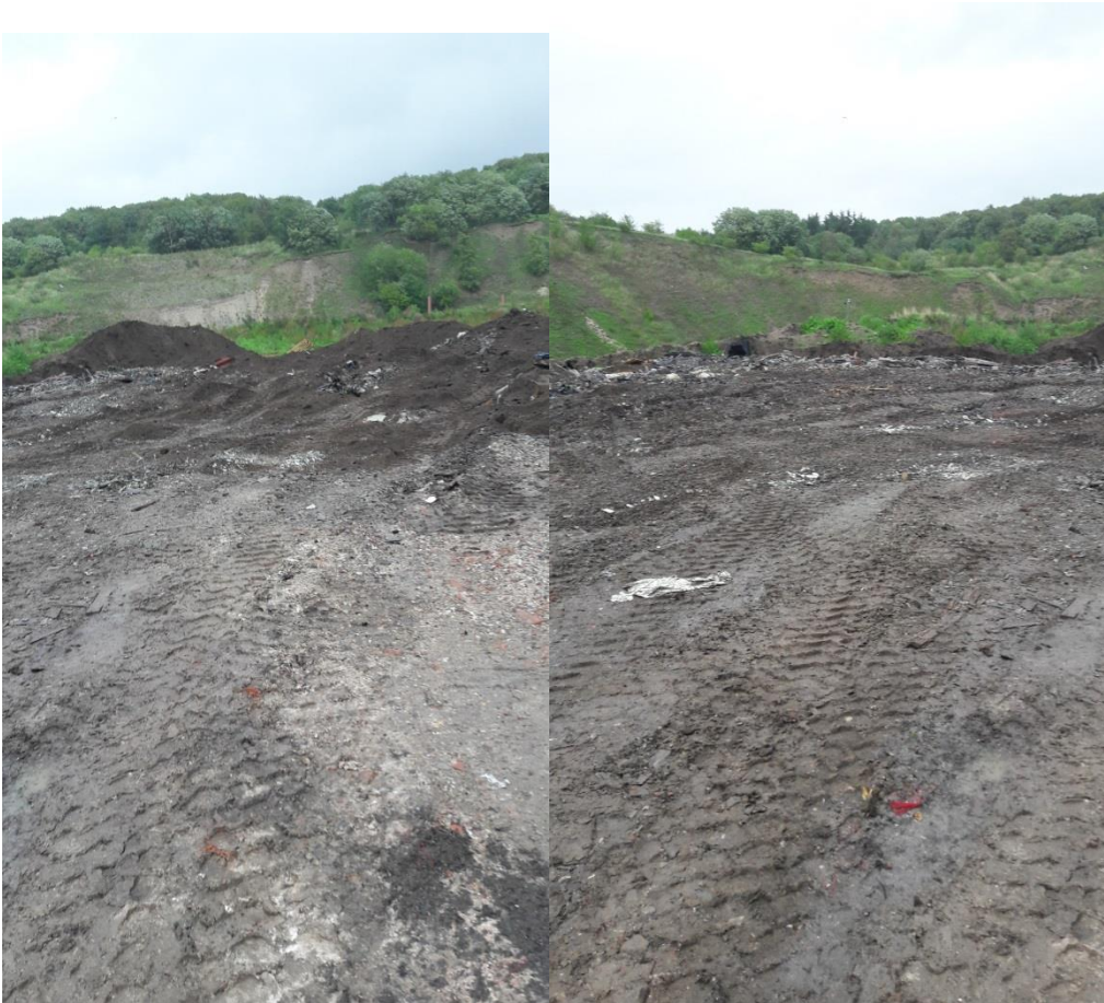
Figur 4 Cellen til Asbest. Der var jordbunker til at afdække asbestplader med. Asbestpladerne kommer ind uden indpakning. Asbestpladerne var ikke alle afdækket. Det var primært et problem i kanten af cellen. Der var tegn på, at kompaktoren havde kørt på cellen.
