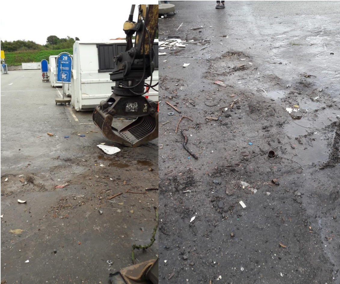
Figur 7 Belægning ved skrotcontaineren var beskadiget. Hældningen på belægningen er væk fra afløbsristene og ud mod kanten af genbrugspladsen. Der lugtede af olie på området.
