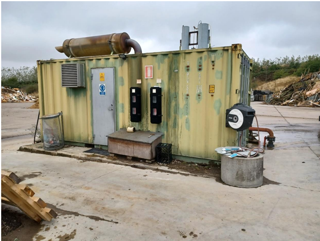
Billede 3 - Container med gasmotor, der udnytter metan gassen i deponiet.
