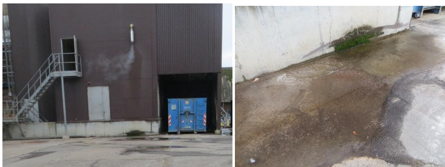
Tv.: afkast med damp fra røggasrenseanlægget. Th.: dråber fra afkastet påvirker belægning og bygning.
