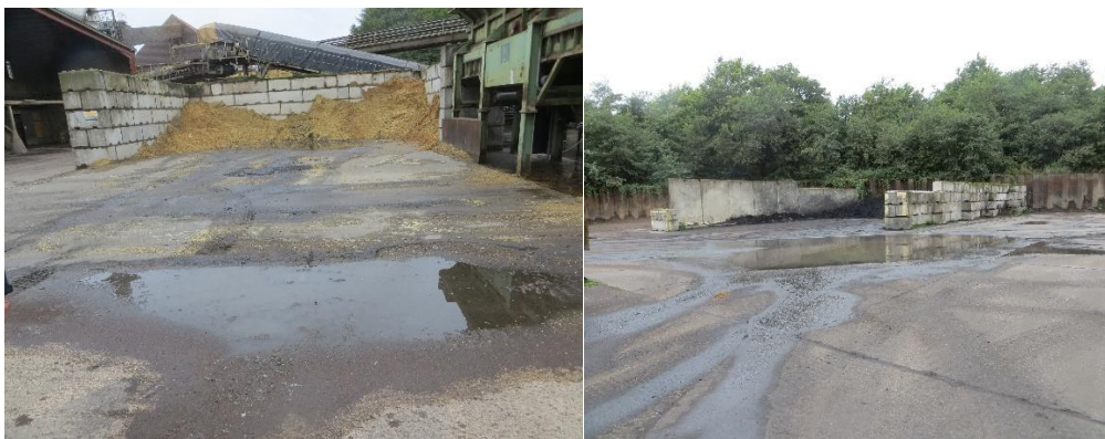
Tv.: Belægning og overfladevand ved bås for neddelt mineraluld anvendt som tilslag klassificeret som farligt affald.
