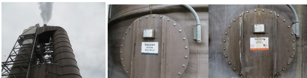
Sur- og basisk skrubber på afkast 7. I bunden udtages henholdsvis gips-slam og salt-slam som restprodukter.
