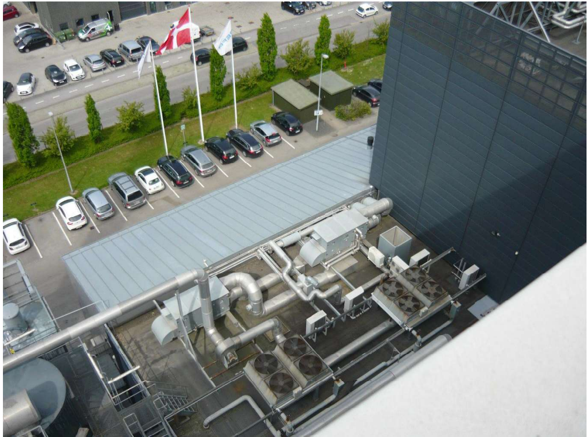
Figur 8: Tørkølere og ventilation på tag af ovnhall 2
