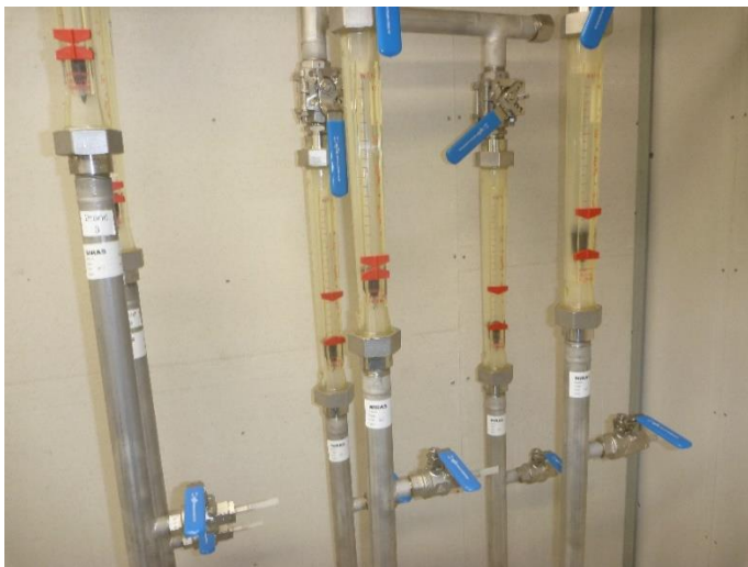
Foto 6: I containeren styres pumper i biocoveret på på baggrund af målt indhold af metan i den oppumpede gas.
