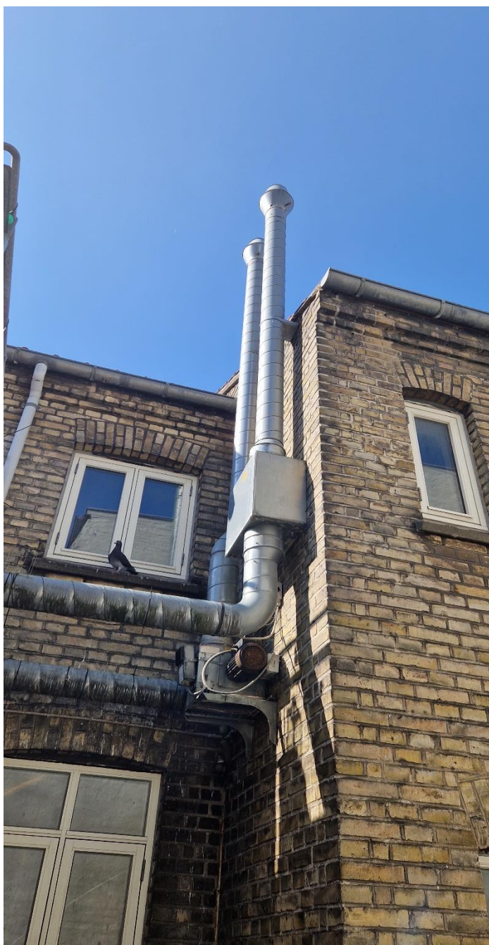
Udsugningsafkast fra de to værkstedrum.
