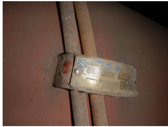
2. Mærkeskilt på indendørs olietank.
