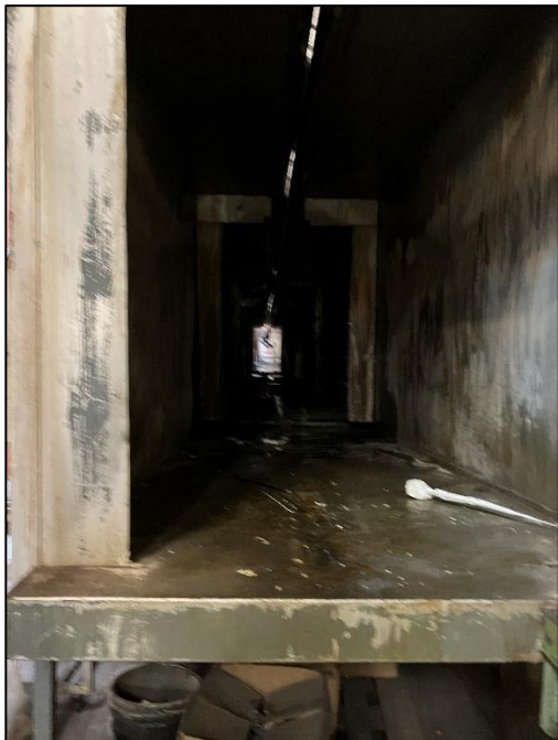
Foto fra trin 1 i fosfateringsanlægget
