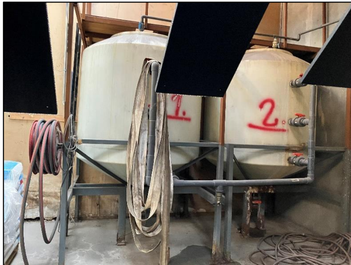
Tanke til bundfældning, sidste trin inden udløb til kloak
