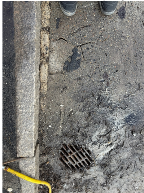
Figur 3. Belægning på vaskepladsen er slidt.
