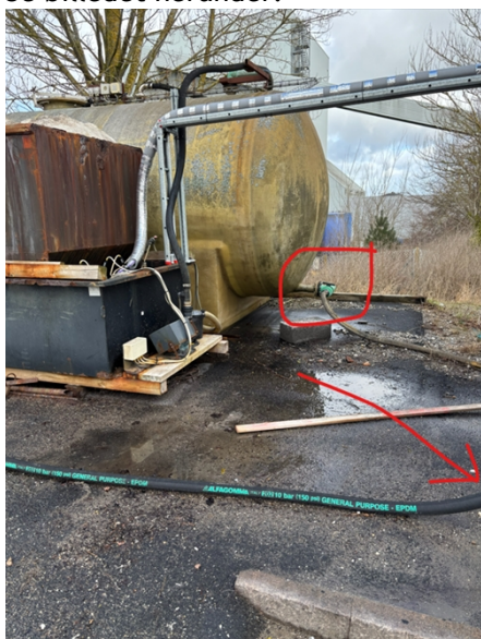
Figur 1. Tank til saltlage er utæt. Mulige spild af saltlage løber af pladsen da faldet på belægningen er udhængsmæssigt indrettet.
