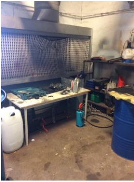
Foto 2: Udsugning i separat rum
