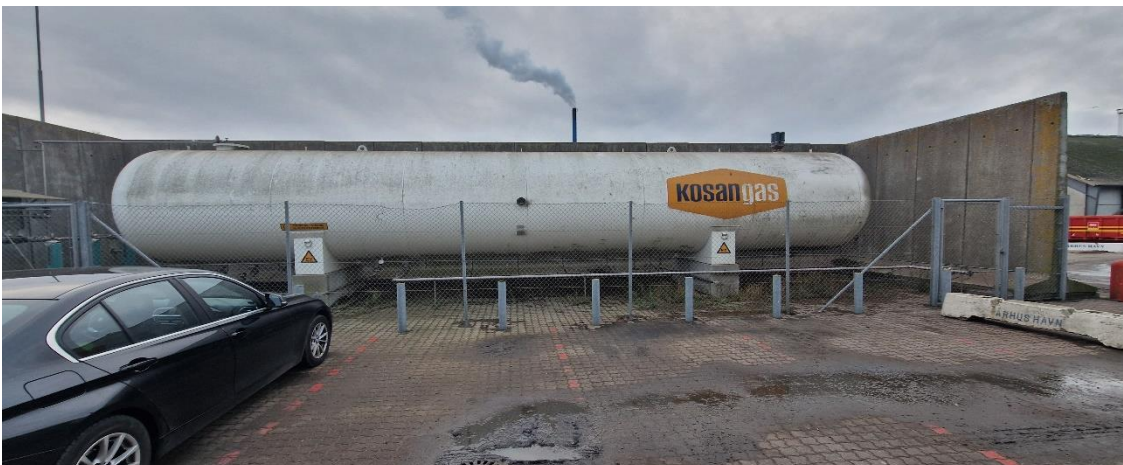
Tank til LPG-gas.
