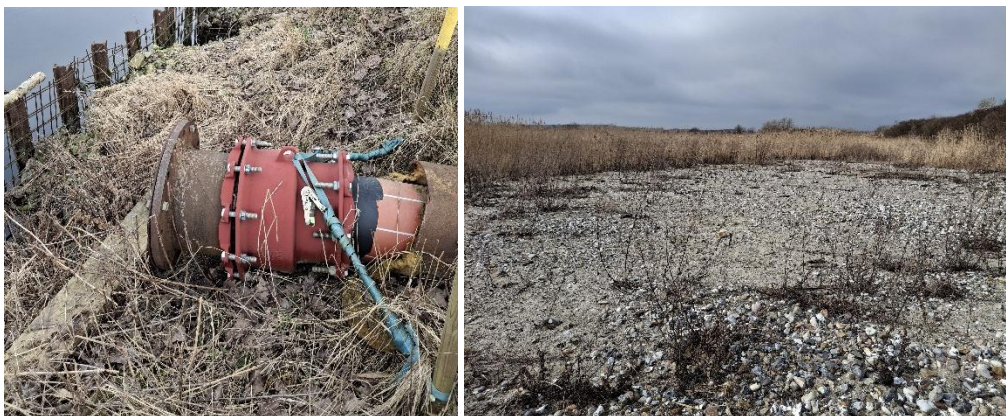
Figur 5: Tilslutningspunkt, fra skib til trykledning (t.v.) og indspulingsområdet i bassin nr. 1 (t.h.)
