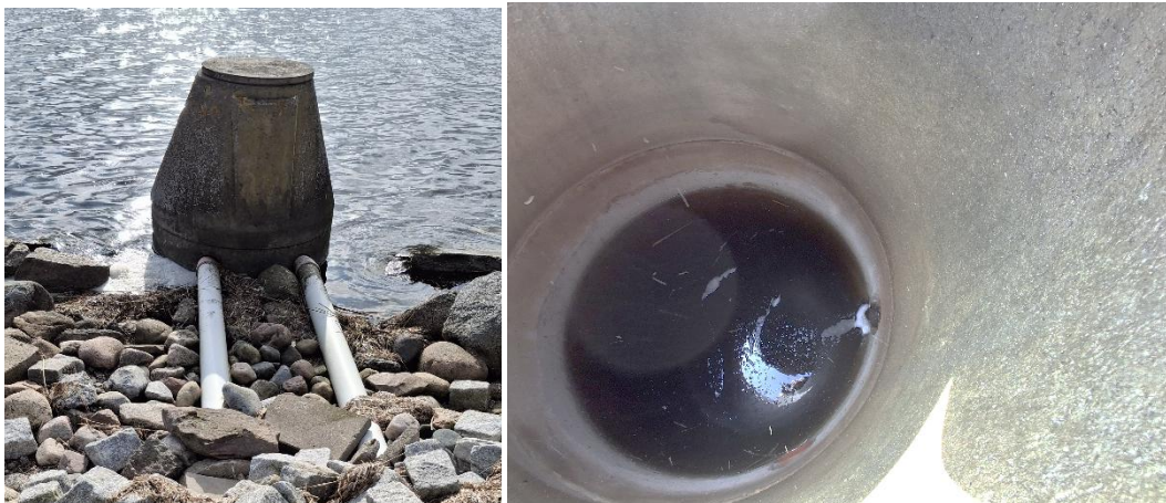
Figur 6: Udløbsbrønden med to tilledninger (t.v.), og placering af tilledningerne i brønden (t.h.)
