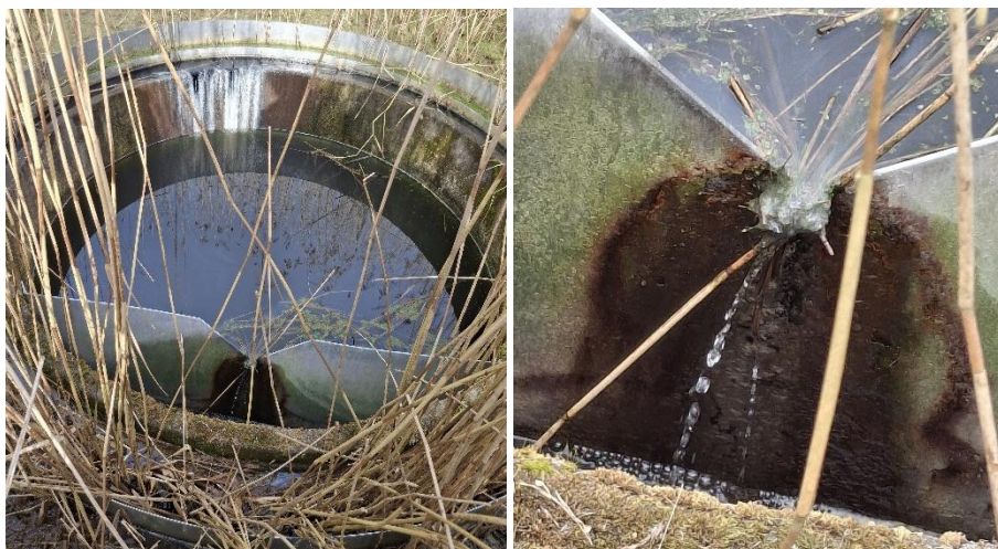
Figur 4: Overløb af vand fra overløbsbygværk i deponiet (ved efterklaringsbassin / bassin nr. 3) til udløbsbrønden som leder i fjorden
