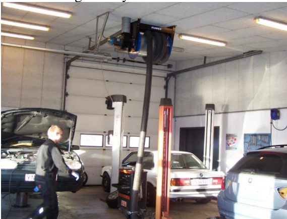
Autoværkstedet med udsugning af udstødningsgasser
