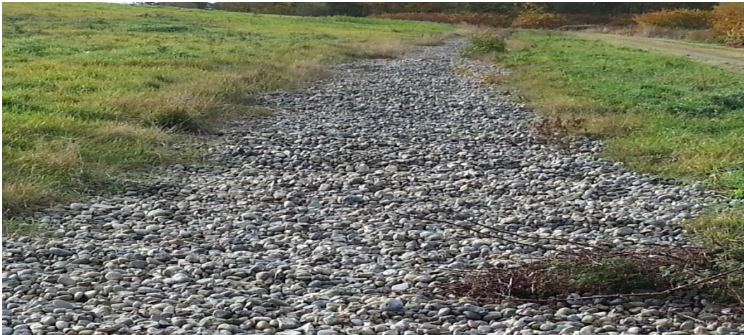
Billede 3: Stenlag med underliggende dræn for afledning af vand der strømmer fra overfladen.
