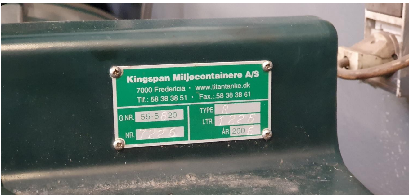
Tankplade på spildolietanken.
