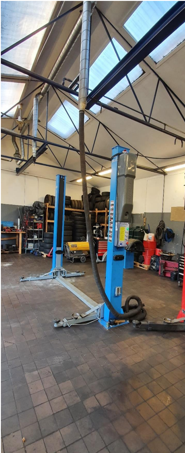
Udsugning på værkstedet.
