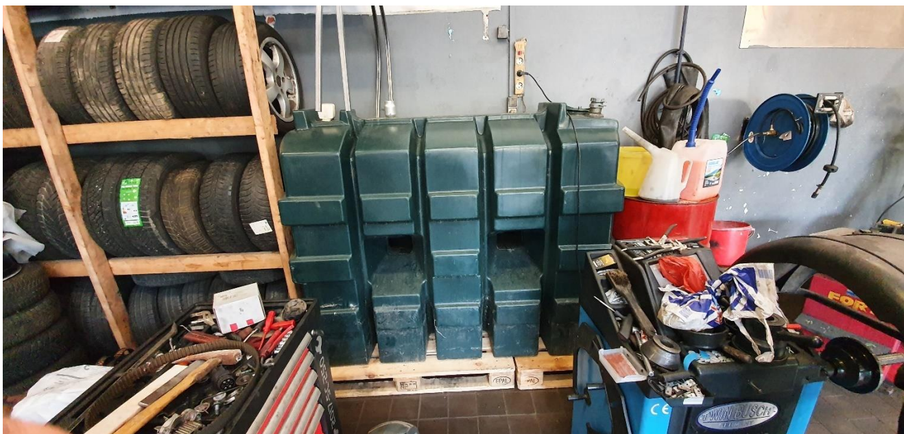
Spildolietank i plast er oplyst til at være dobbeltvægget.
