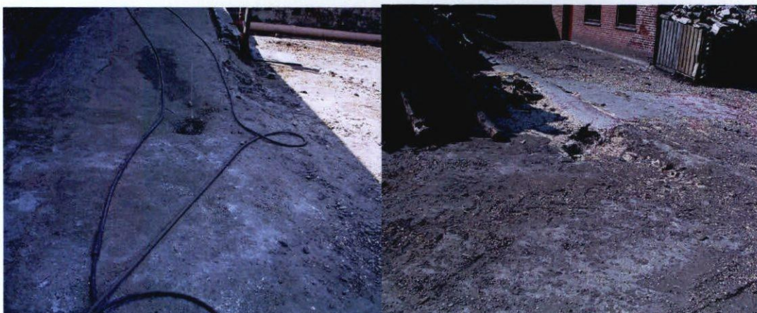
Nødoverløb fra stald, placeret i møddingsplads Afløb fra møddingsplads til gylletank
