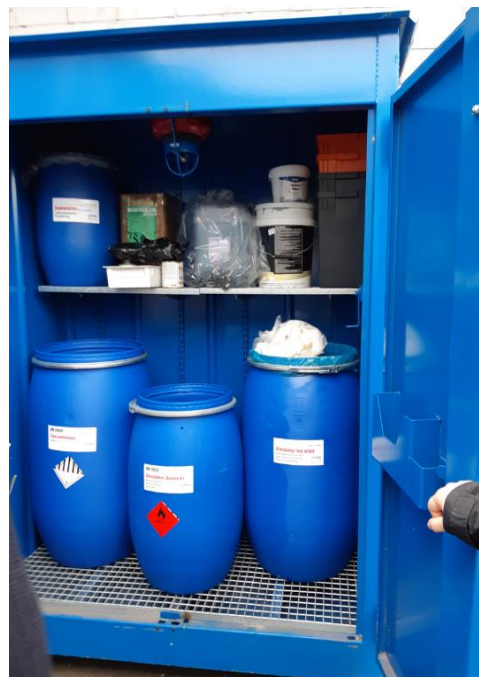
Miljøstation - Stort Miljøskab. Indbygget brandslukning i loft af skab.
