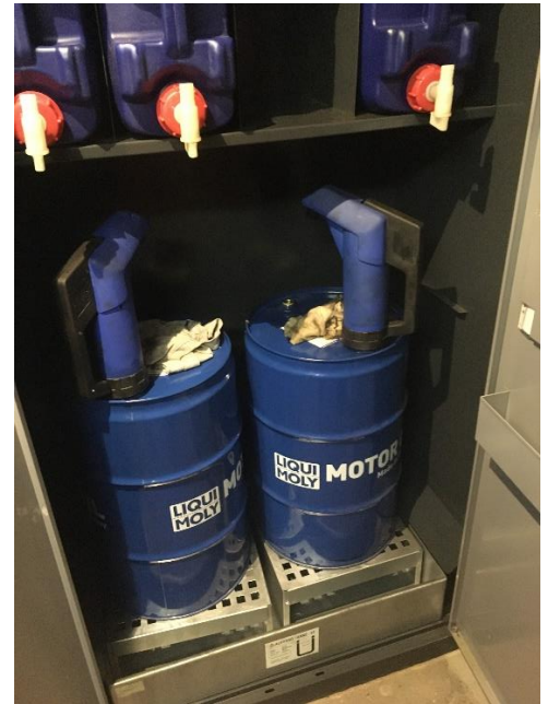
Kemikalieopbevaring i miljøskab med spildsikring.
