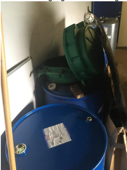
Opbevaring af affald af kølevæske i plastiktromle uden spildsikring
