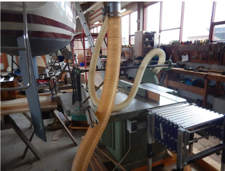
7. Station med punktudsug.
