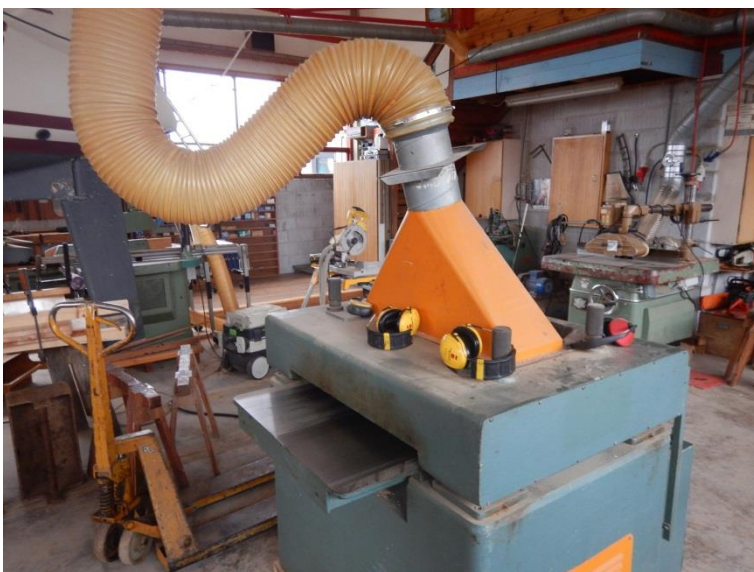
5. Station med punktudsug.
