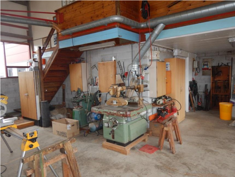
6. Station med punktudsug.
