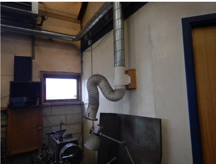
18. Station med punktudsug.
