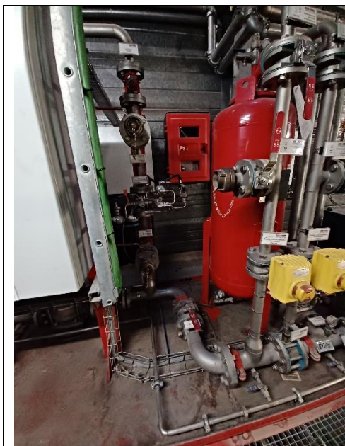
Skumslukningsanlæg i silo 1
