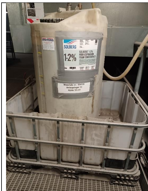
Brandsluknings-skum i silo 2
