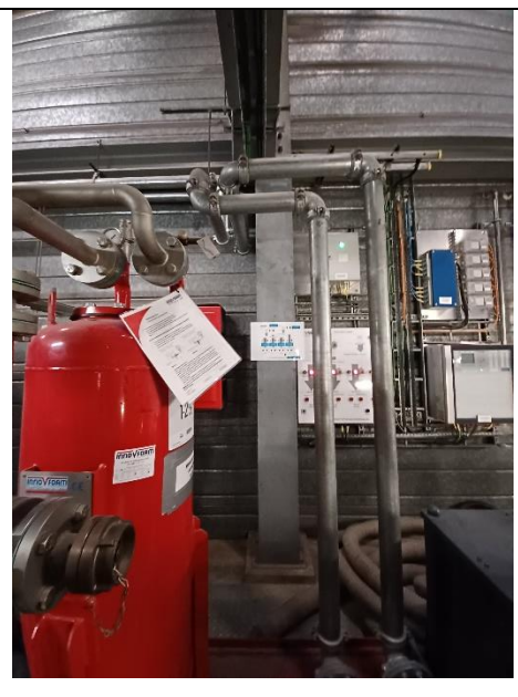
Skumslukningsanlæg i silo 1
