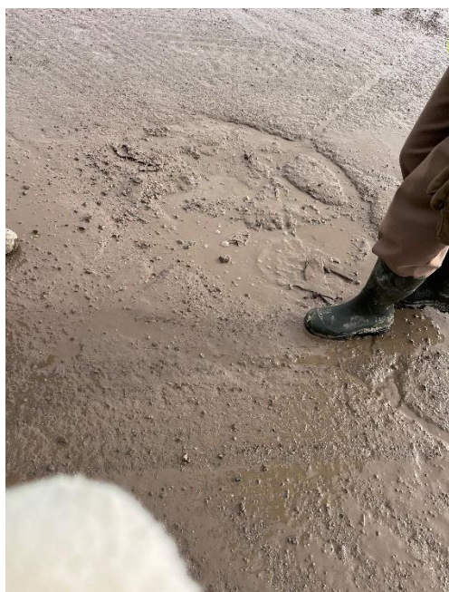
Belægning der er markeret i virksomhedens vedligeholdelsesplan - udbedringsplan
