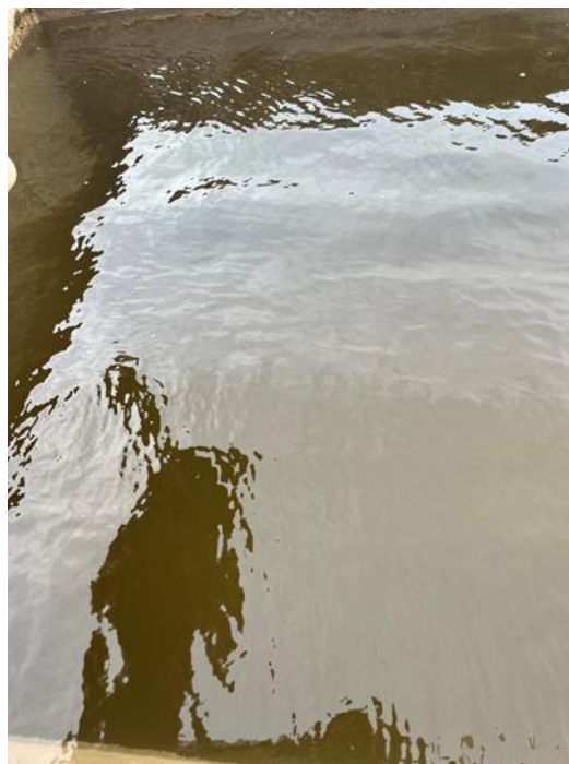
2. trin i vandrenseanlæg. Sedimentationsbeholder før behandling i lameludskiller
