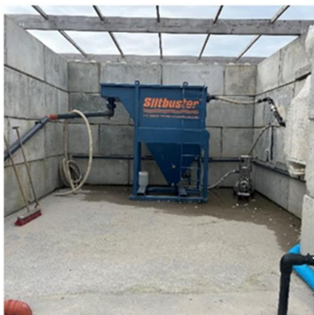
3. trin i vandrenseanlæg Lameludskiller, hvorfra der udtages prøver før afledning til recipient.
