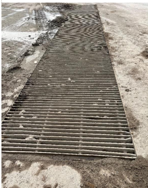
Vaskeplads med bundfældning under rist
