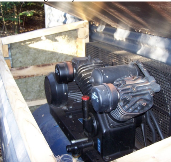
Stempelkompressor, placeret i buldrekasse syd for bygning 3
