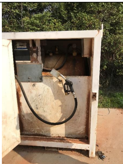
Et kig ind i containeren med dieselolietank. Der er sat en plade på bag lågen, således at olien vil tilbageholdes i containeren i tilfælde af, at tanken lækker
