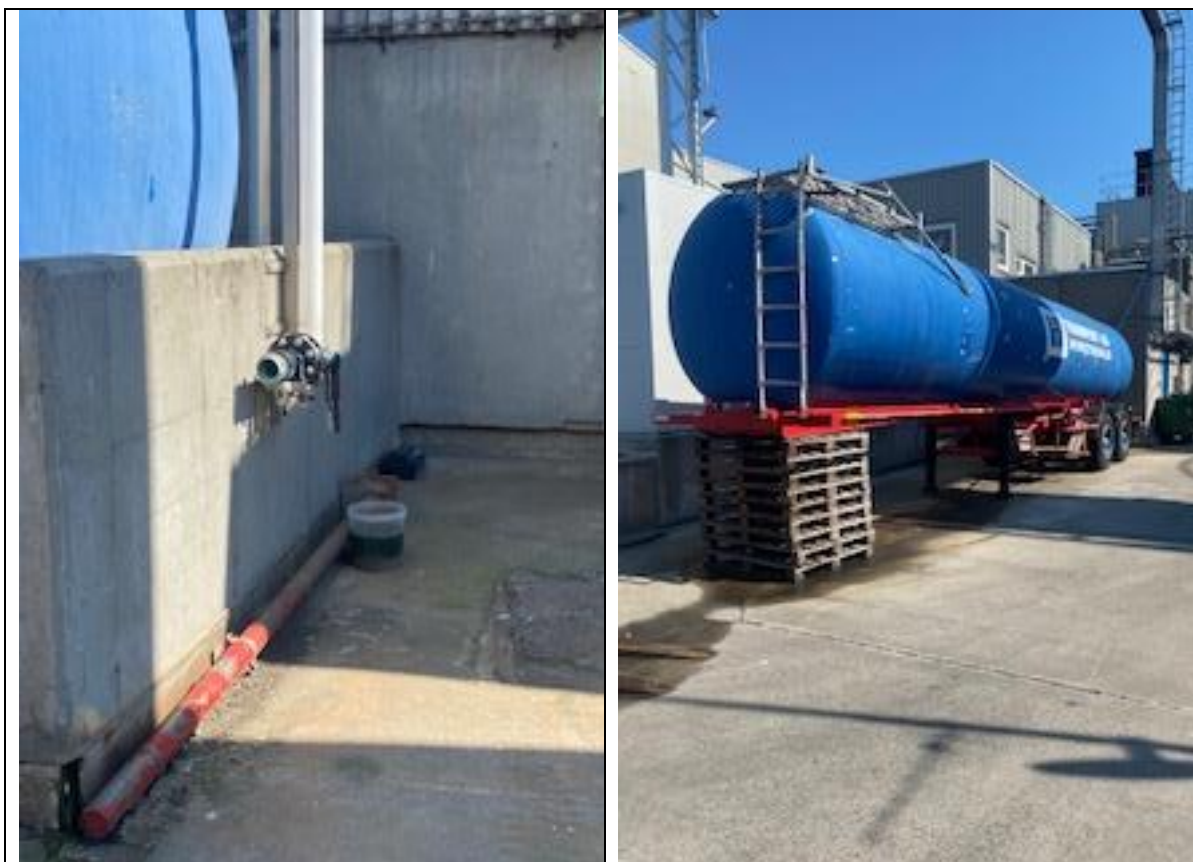
Foto 1: Påfyldningsstuds til tank med formalin
