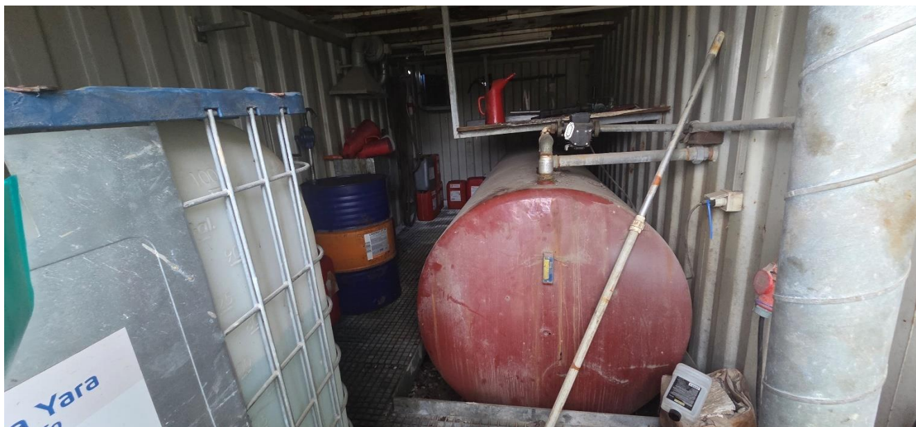
Dieselolietank står i en miljøcontainer.
