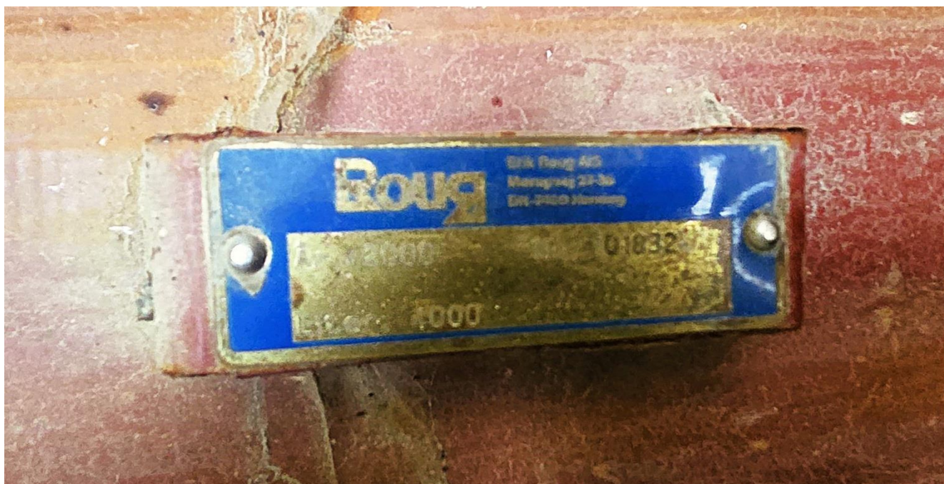
Tankplade på dieselolietank.
