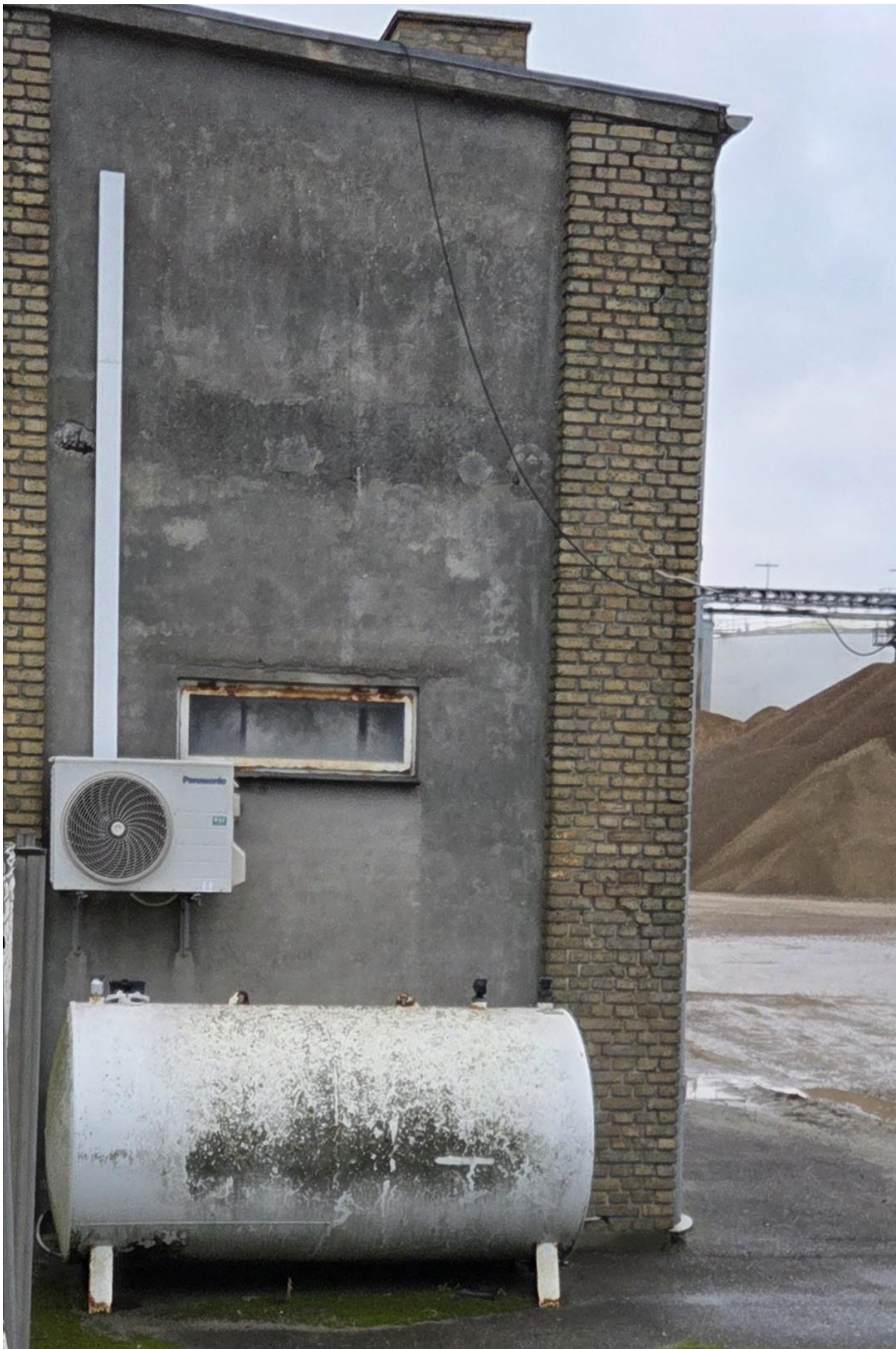
Fyringsolietanken står ved administrationsbygningen.
