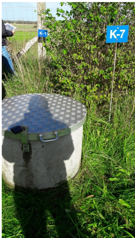
K7 er beskyttet af brøndring og forsynet med aflåselig låg.
