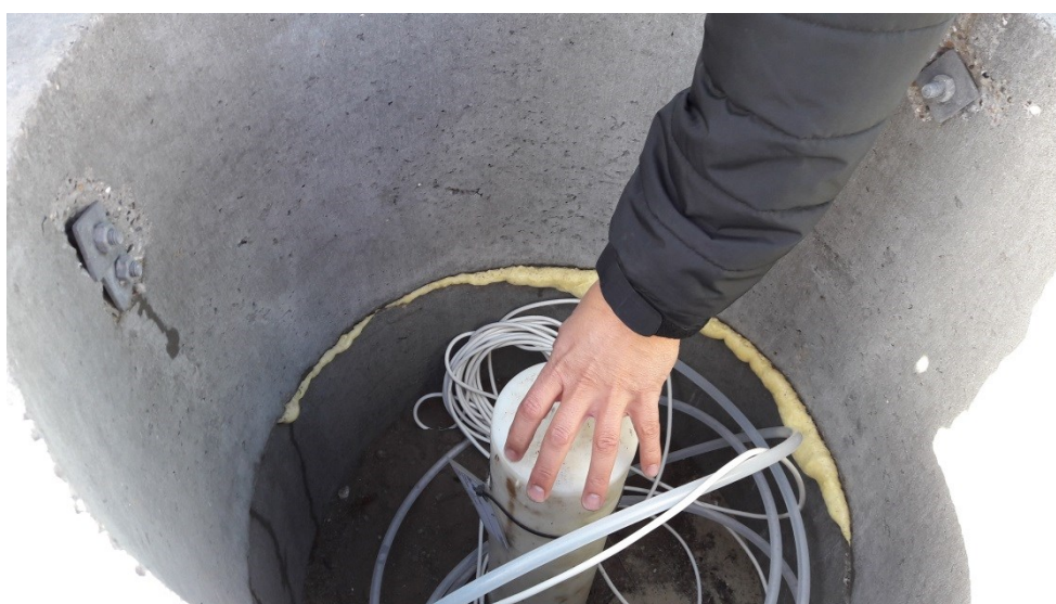
Et kig ned i K7. Forerøret er forsynet med prop.
