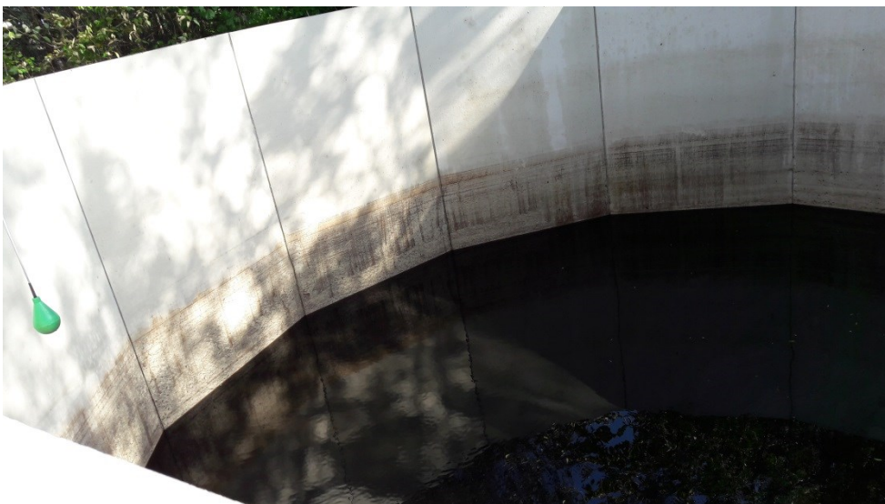
Forsinkelsesbassinet med føler, der registrerer perkolatniveauet i tanken.
