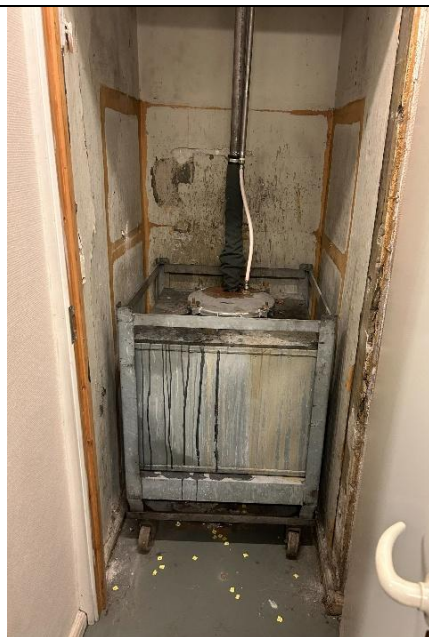
Figur 10: Tank til rensesvæskeaffald
