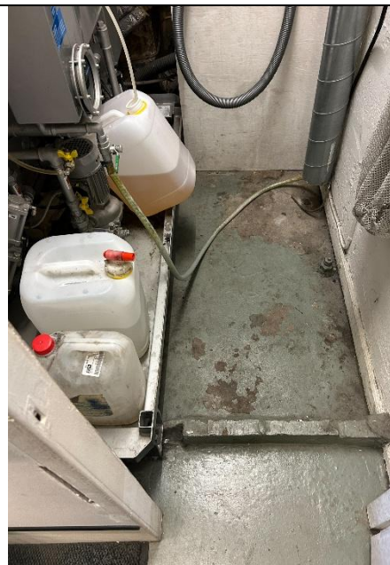
Figur 9: Opbevaring af produkter på spildbakke i bagrum til rensemaskine.
