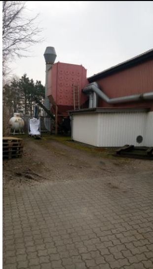
Billede nr. 2: Filter og afkast, opsamling af støv i bigbag, samt propangastank.
