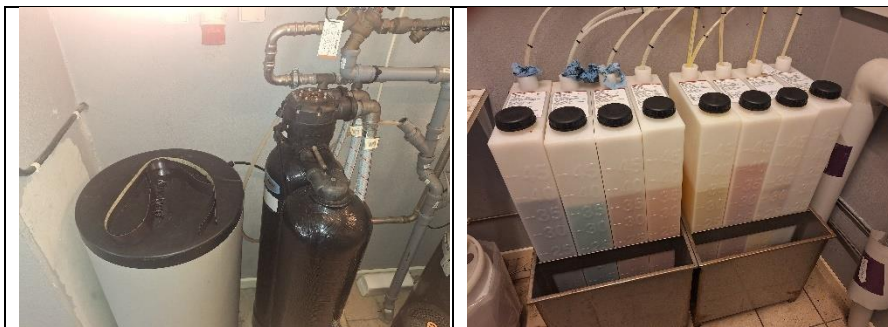
Ionbytter og vaskemidler placeret på spildbakke
