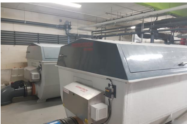
De 2 nye tromlefiltre til 50 meter bassinet
